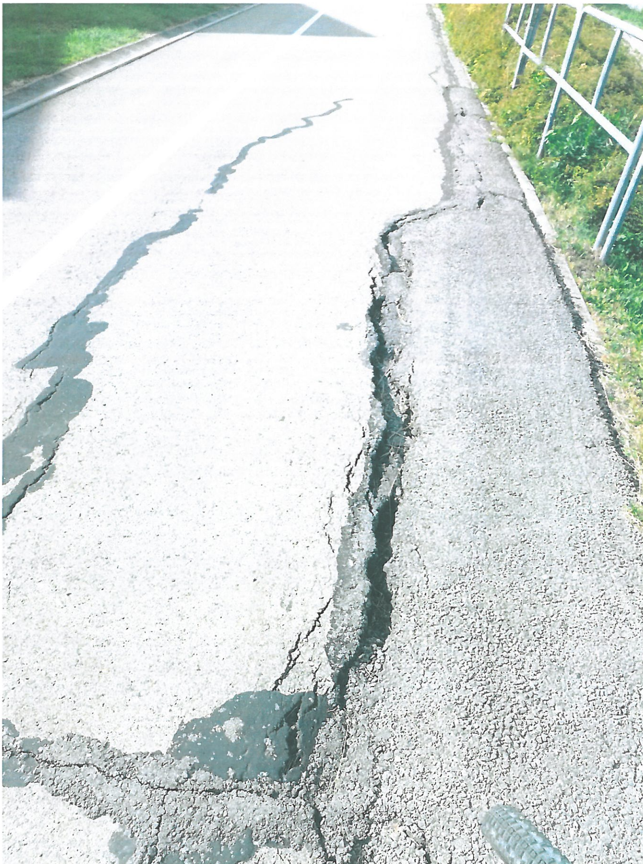
Rysunek 1. Głębokie pęknięcia w drodze dla rowerów
